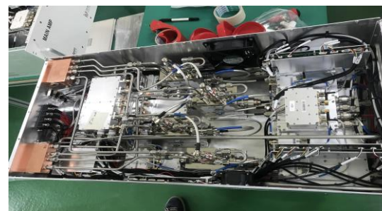
162.5MHz 4kW PA unit
