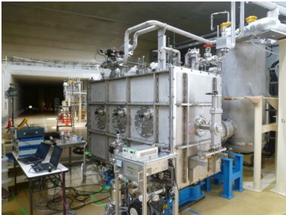
cERL 1.3 GHz Injector Cryomodule
